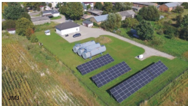
Stacja Uzdatniania Wody w Królewcu, 2022 rok
