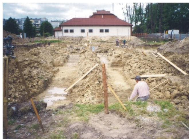
Teren pod budowę nowego Urzędu Gminy przy ulicy Chelmońskiego w Mińsku Mazowieckim, 1999 rok
