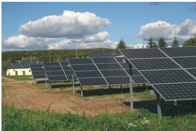
Panele fotowoltaiczne przy stacji uzdatniania wody
